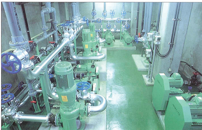
■地下ポンプ室
